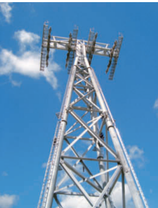
Ce haut pylône du Funitel de Val Thorens est déjà en place – il manque encore les câbles.
