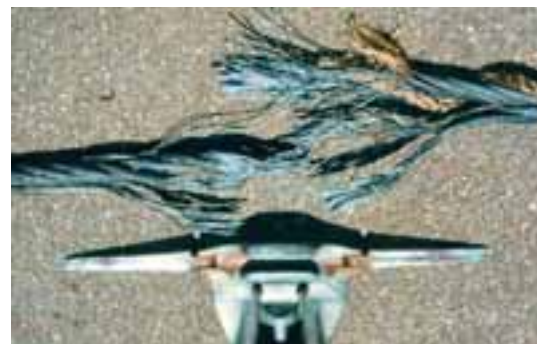
Un câble porteur-tracteur s'est rompu en raison de flexions répétées aux extrémités de l'attache
